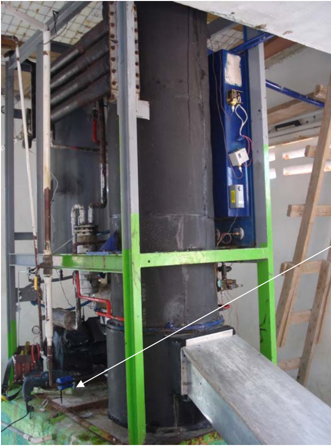
Instalación de IMANES FF2 en máquina de Hielo Vogt F 118 en Hotel SANDOS PLAYACAR.
